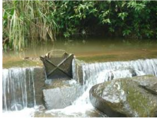
REPRESA SOBRE EL CAUCE.
